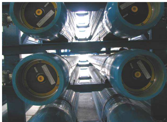
Bastidor de ósmosis inversa en Bocabarranco (CIAGC)
